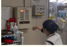
火災報知器/非常電話
